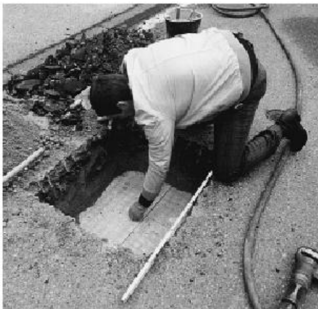
Σχέδιο 6: Πλάκα Διογκωμένου Πολυστυρενίου (EPS) για την προστασία παγετού στην οδική κατασκευή. Δείγματα που λαμβάνονται 11 έτη μετά από την εγκατάσταση. Τα πανέλα αφρού Styrogor ήταν στην ίδια κατάσταση όπως όταν εγκαθίστανται.
